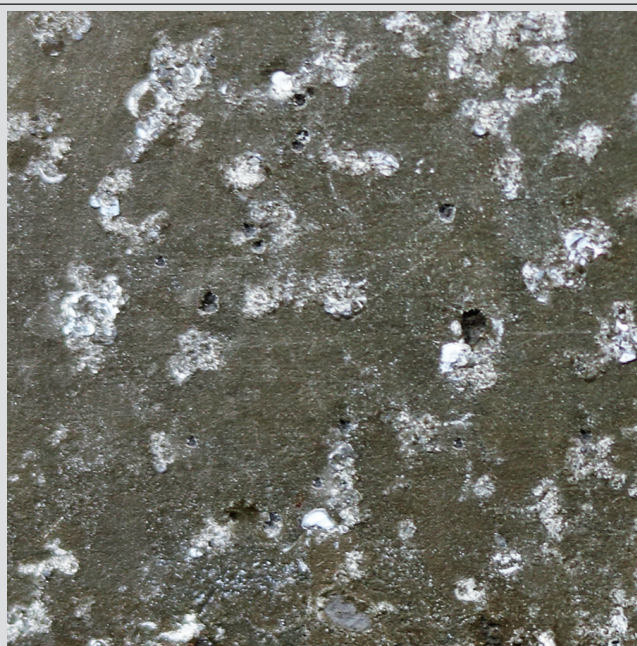
Dettagli sulla corrosione superficiale
